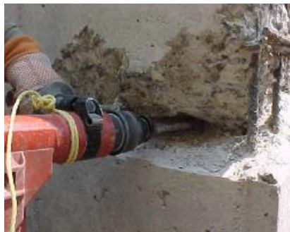
Uso de herramienta de corte Abrir la oquedad o junta, en donde se tiene la fuga activa
